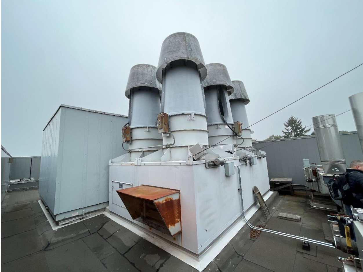
Photo 6: Exhaust Fan EF-1
